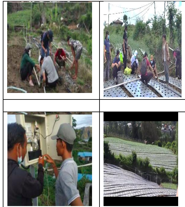
Gambar 1. Instalasi Sistem Irigasi dan Penyiraman berbasis IoT
